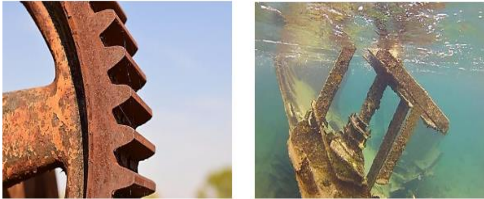
Figure II.3: Photos de matériaux soumis aux phénomènes de corrosion.
