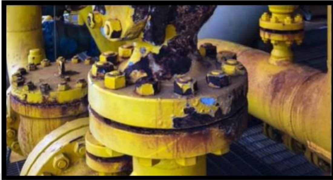
Figure I.10 : La corrosion caverneuse.
