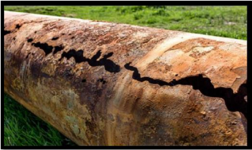
Figure I.9 : la corrosion érosion des canalisations.
