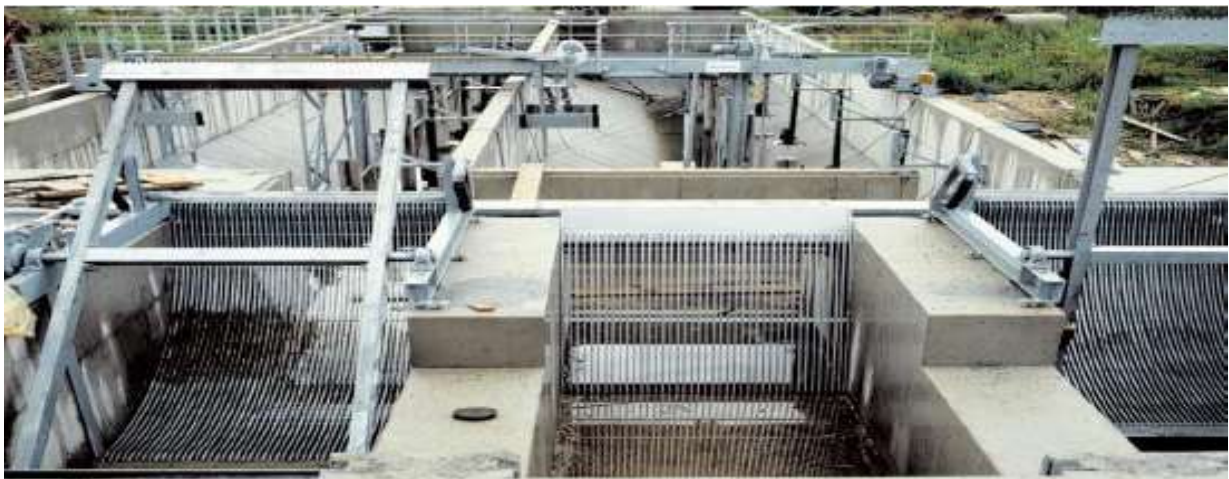
Figure II.3 : Photo présente une station de dégrillage
