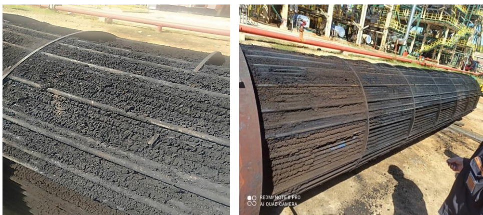
Figure IV.3 : Faisceau tubulaire colmaté de l'échangeur 100-E1A
