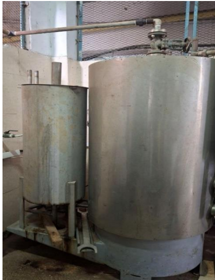
Figure IV.5 : Générateur de vapeur utilisé dans le système de traitement des DASRI (Photo originale 2026).
