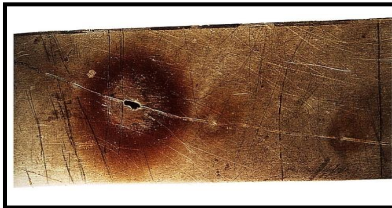
Figure. I.4 : Corrosion par piqûres sur la paroi d'une cuve en acier Inoxydable austénitique Cr18Ni10.
