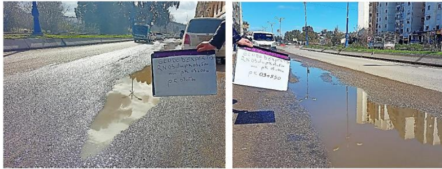
Déformation de la surface au PK 03+500 (sens aller)
