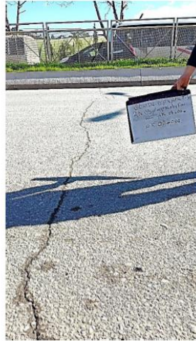
Fissures transversales au PK 05+000 (sens aller)
