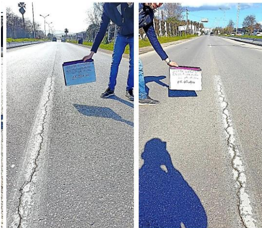
Fissures longitudinales au PK 05+300 (sens aller)
