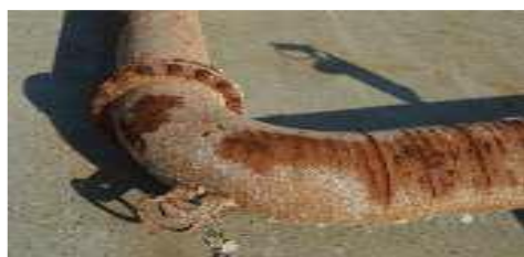
Figure I.1 : Tuyau de métal corrodé détruit.[3]
