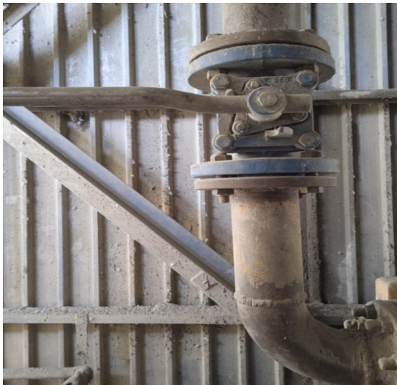
Fig. I.15 : vanne d'arrivée gaz général.
