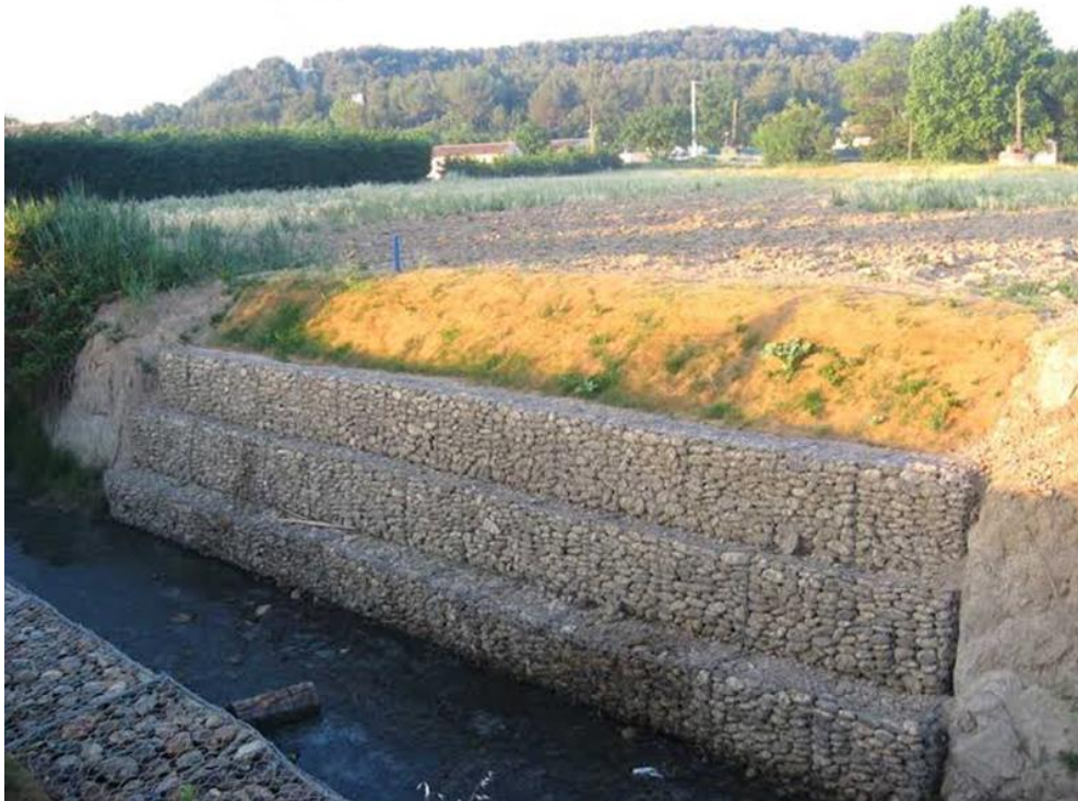
Figure IV.20. Protection des berges par gabions.
