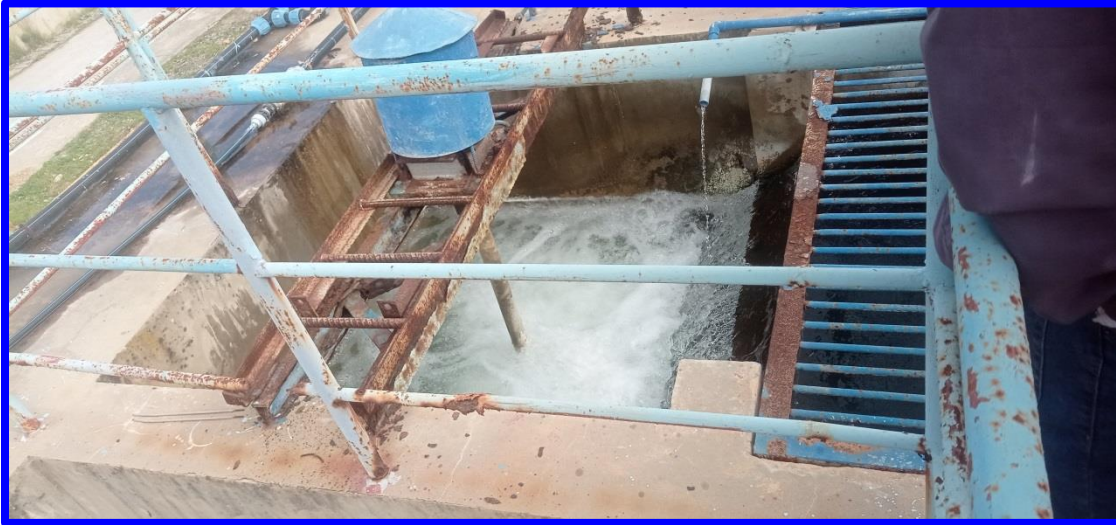
Figure II.7. Bassin de mélange mécanique.
