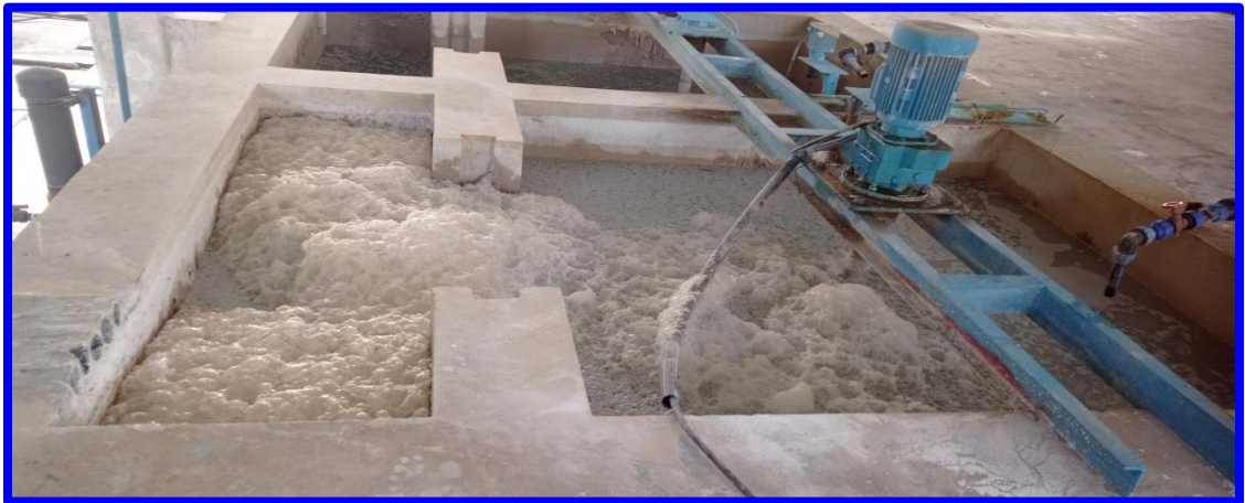
Figure II.9 bassin de sulfate d'alumine
