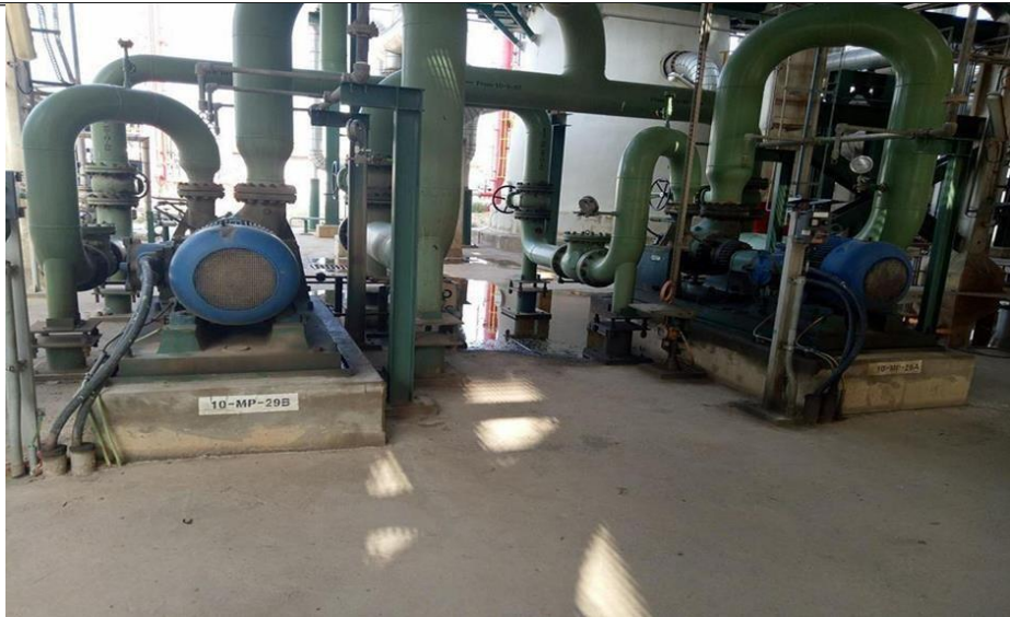
Figure 3 : Les pompes 10-MP-29A/B
