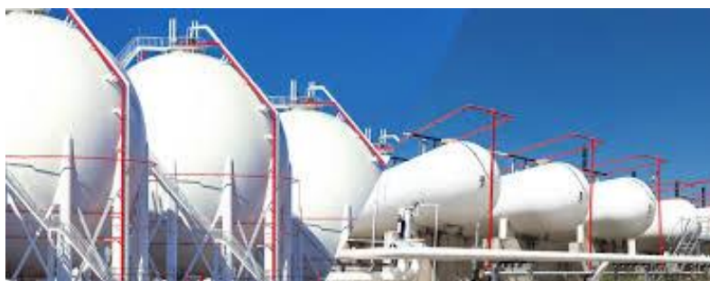
Figure I.9 : Sphères, cigares stockage GPL.
