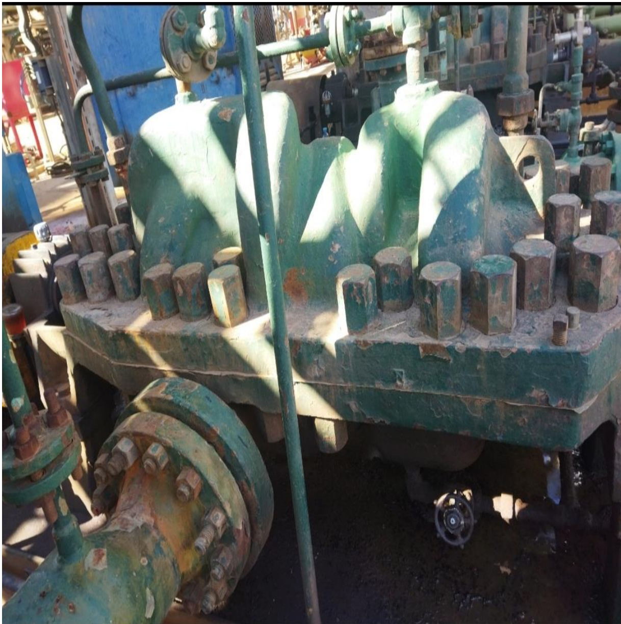
Figure III.15 : photo réelle de la pompe 100-P2A.
