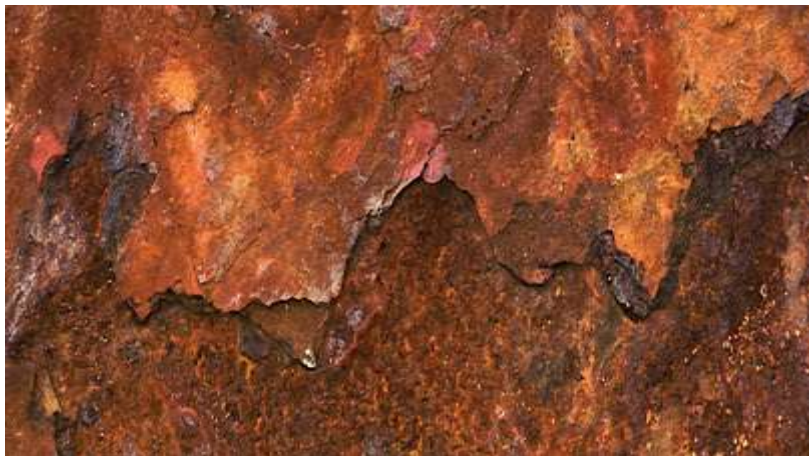
Figure II .2 : Exemple de corrosion généralisée.
