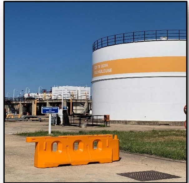
Figure 2 : Zone de traitement des boues résiduaire –section 501
