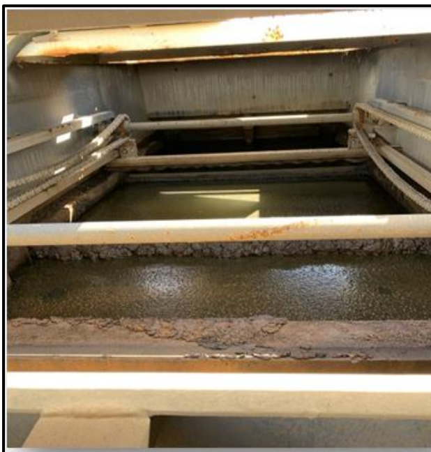
Figure 3: bassin de décantation ME003
