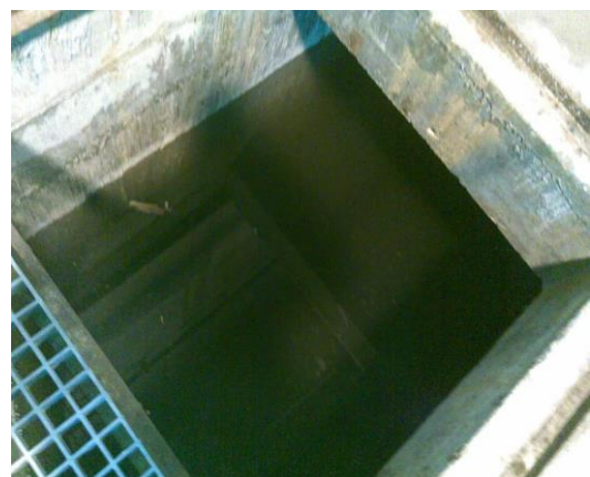
Figure (9). Bassin de captation
