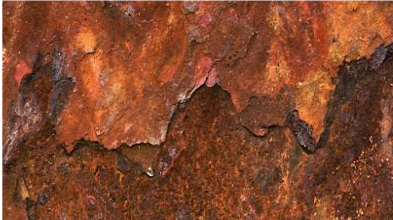
Figure II.4: Exemple de corrosion généralisée [43]
