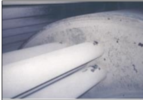
Figure II.3 : Entartrage d'une chaudière à tubes de fumée (P= 15 bars). [24]
