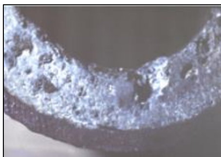
Figure II.4 : Dépôt de forte épaisseur dans un tube de surchauffeur de chaudière MP. [26]
