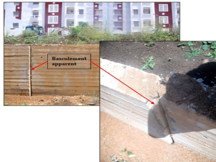
Figure II.9: Basculement du mur de soutènement.
