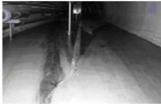
Figure I.13 : Soulèvement puis dislocation du radier d'un tunnel ( Wakim, 2005 ).
