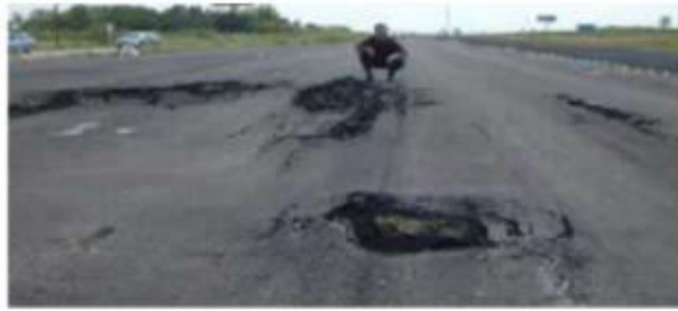
Figure I.12: Dégradation de chaussées ( Djaani et Benmansour, 2016 ).
