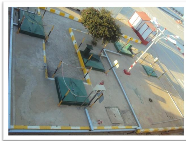
Figure III-3 : Bassin de neutralisation
