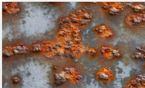
Figure I.12 : la corrosion inter-granulaire
