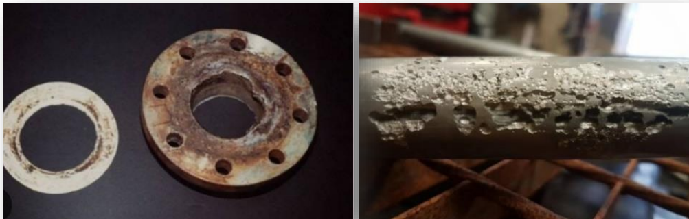
Figure I.10 : la corrosion caverneuse
