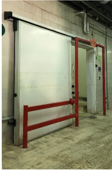
Figure N° 16: Chambre froide (cliché personnel).
