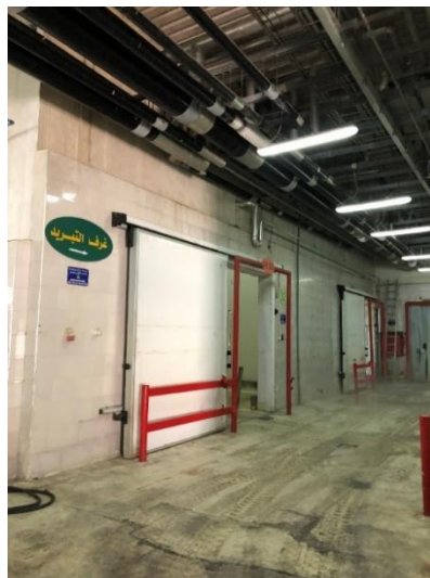
Figure N° 15 : Tunnel de congélation de l'abattoir public (cliché personnel).
