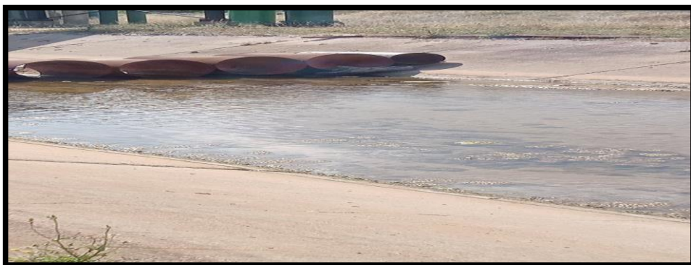
Figure 18 : Canal de rejet du la central thermique électrique (CTE)
