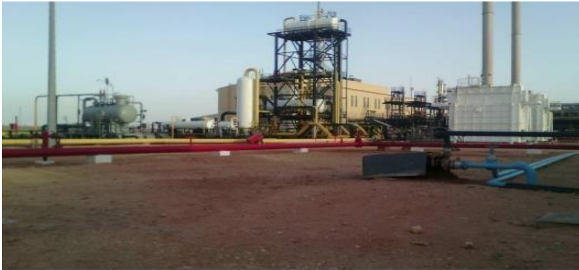
Figure II-9. Unité 20 (traitement de brut et de gaz d'ONR) [43].
