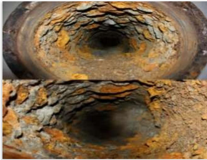
Figure 27 : Photo de corrosion par érosion.
