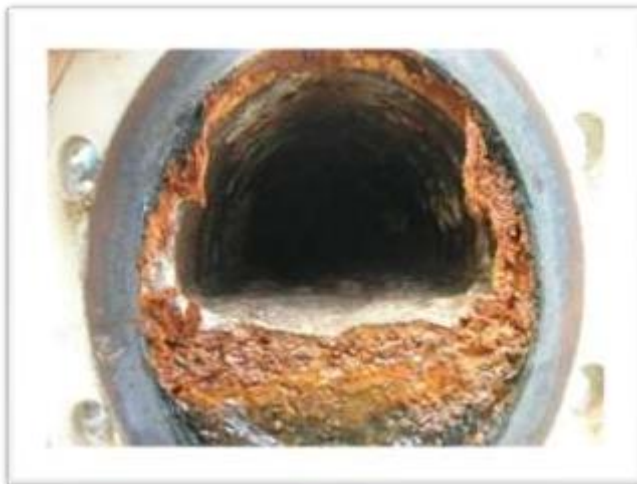
Figure 13 : Corrosion bactérienne bio-corrosion dans l'eau
