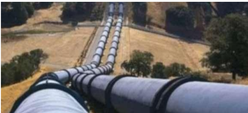
Figure 4 : Des gazoducs aériens
