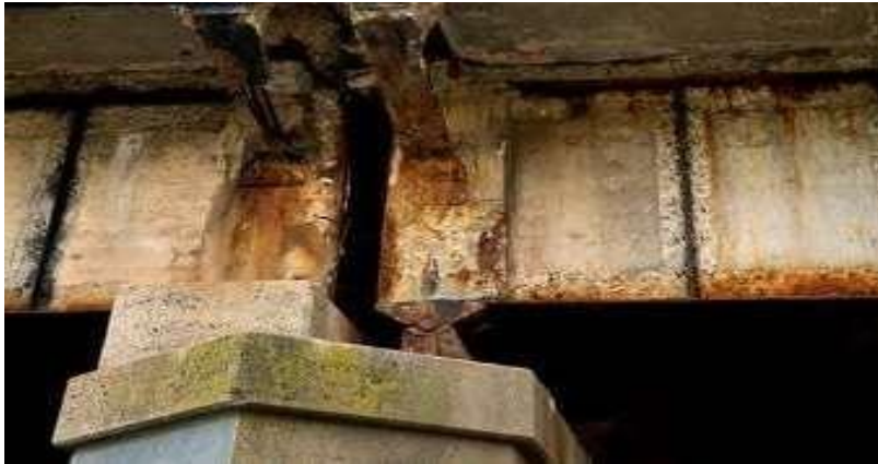
Figure 31 : Corrosion par fatigue
