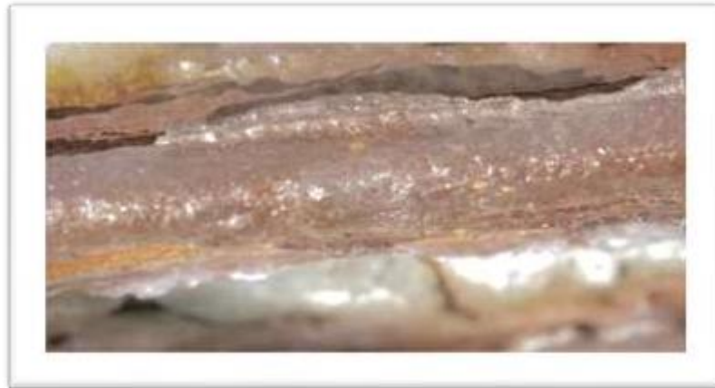
Figure 34 : Exemple de la corrosion exfoliante
