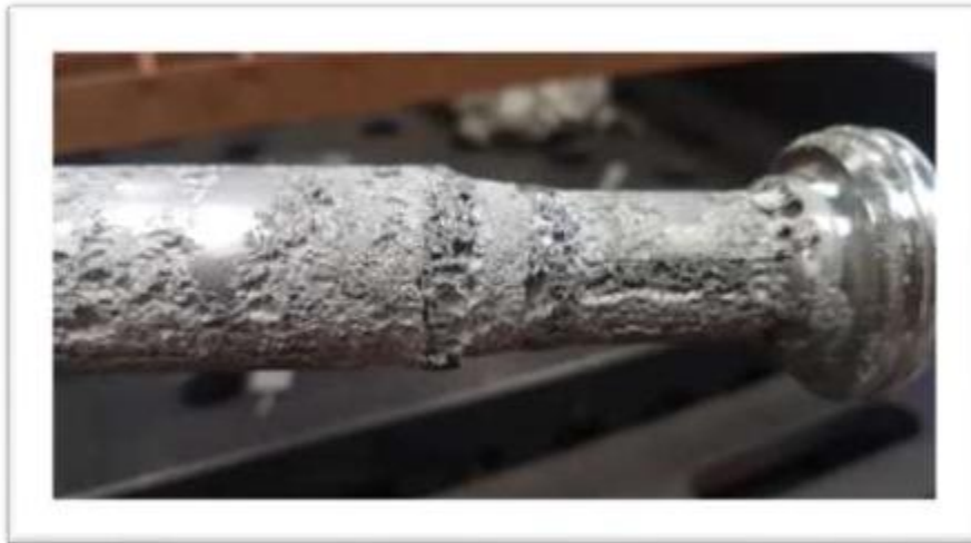
Figure 20 : La corrosion caverneuse.
