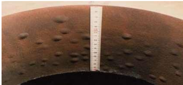
Figure 33 : Exemple de corrosion par hydrogène.
