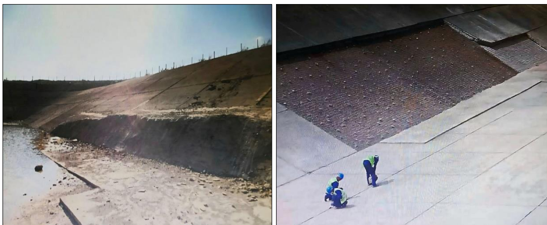
Figure III.7. Déformations (gonflements) et fissures au niveau de la structure en béton de Réservoir N°03 d'EL Harrouch (ONID, 2025)
