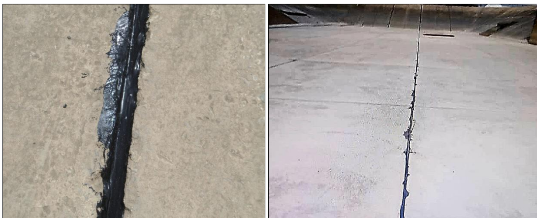
Figure III.8. Les joints de dilatation entre les gradins des réservoirs du périmètre Saf-Saf (ONID, 2025)
