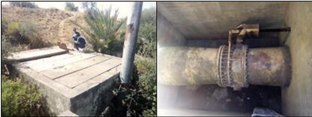
Figure III.9. Chambre de vanne et ses équipements
