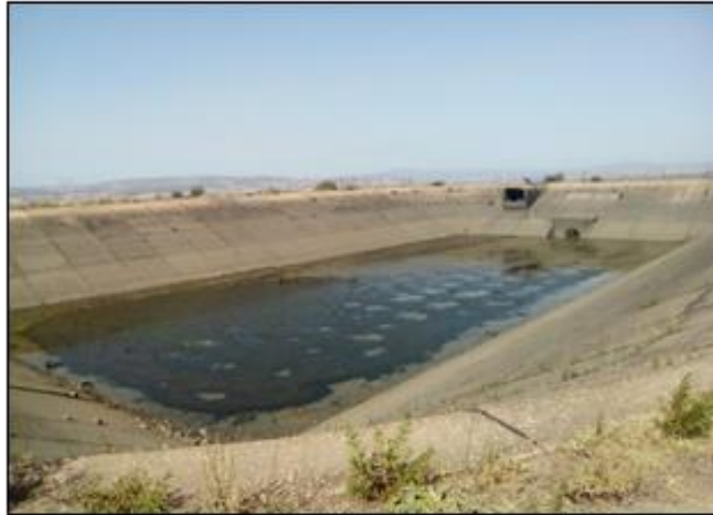
Figure III.11. Contamination des déchets au fond de Réservoir N°4 d'Emdjez-Edchiche
