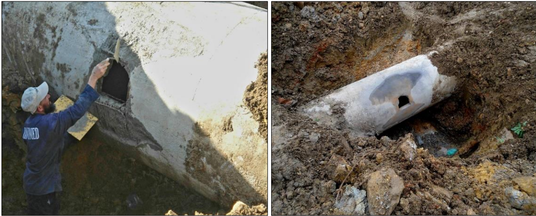
Figure III.5. Fuite détectée sur une conduite d'eau d'irrigation dans le secteur I de Ramdane Djamel (ONID, 2025)
