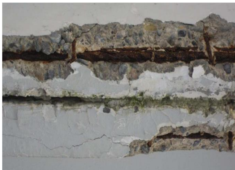
Fig II.12 : Corrosion généralisée des armatures (par carbonatation) sur une poutre en béton armé [36].
