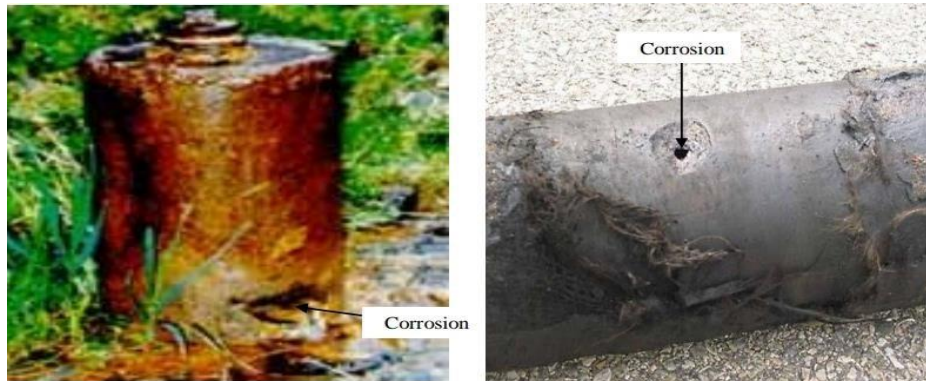
Figure 6: Corrosion par caverneuse.
