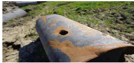
Figure.10a Percement d'une canalisation d'eau enterrée dans le sol de Mila (K.Belmokre).
