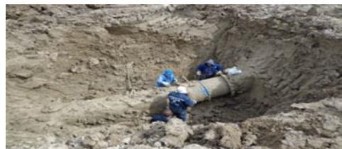
Figure.10b Déboîtement d'une enterrée canalisation d'eau enterrée dans le sol dans le sol de Mila (K.Belmokre).
