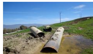
Figure.10c Corrosion interne et externe d'une canalisation d'eau enterrée dans le sol de Mila (K. Belmokre).
