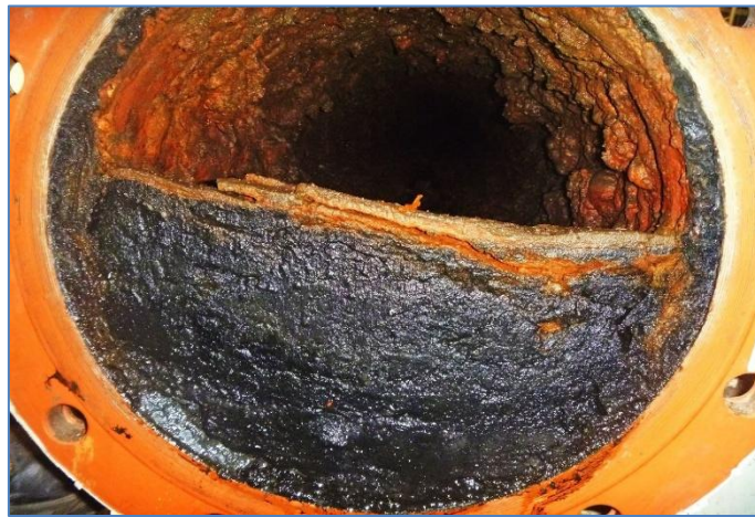
Figures II.1: Accumulation de dépôts et corrosion à l'intérieur d'une conduite industrielle.[35]
