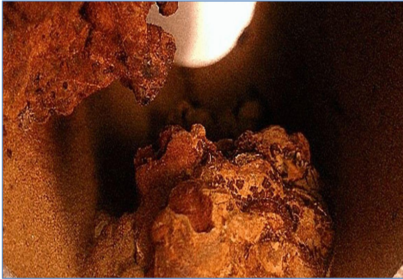
Figures II.5 : Encrassement sous corrosion.[49]
