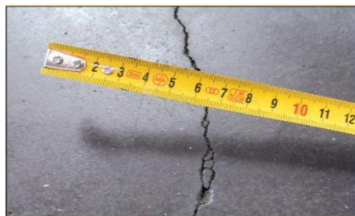
Figure 1.15. Ouverture importante des fissures de retrait
