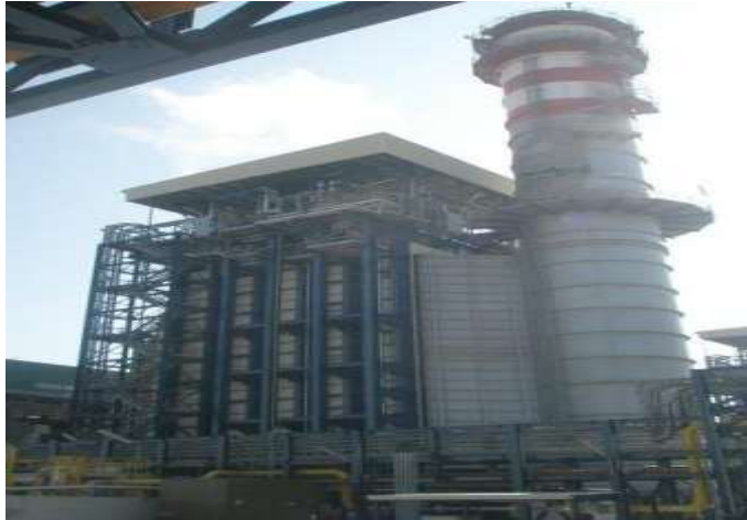
Figure I.2 : Chaudière de récupération [12]
