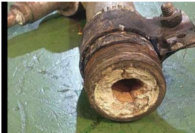
Figure II.3 : encrassement par entartrage
