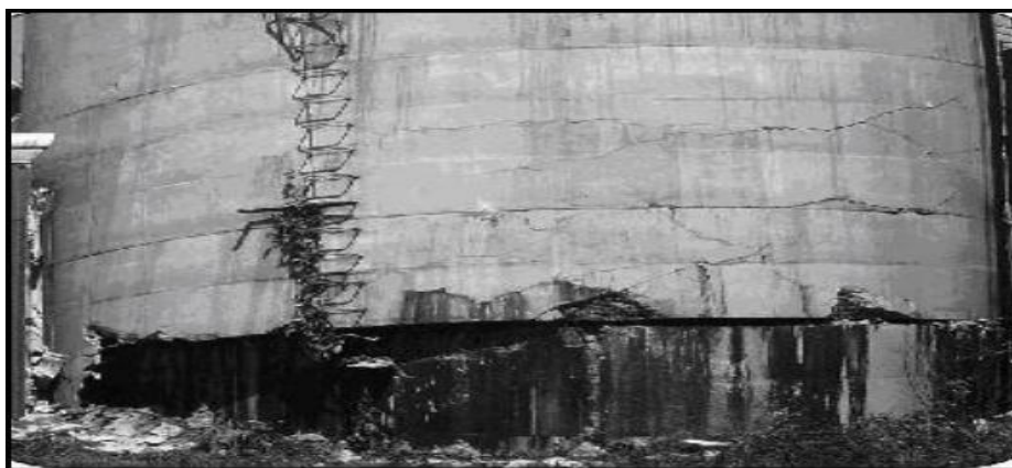
Fig. I.6 : La détérioration des silos-tours en béton due à l'attaque des acides d'ensilage.
