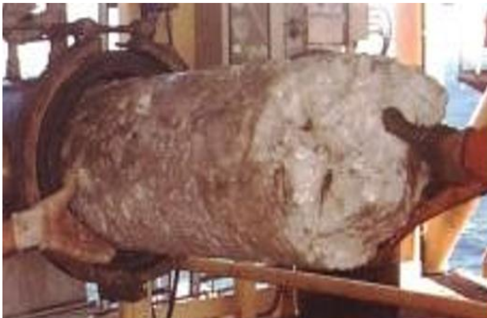
Figure (III-1) : bouchage d'une conduite par le givrage des hydrates. [8]
