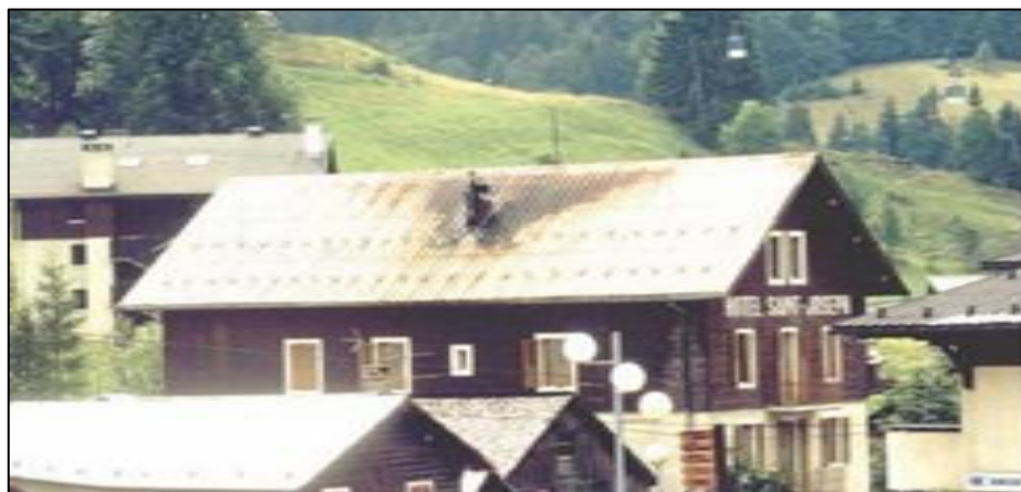
Figure II.2 : Corrosion sèche par les gaz acides due à la combustion du charbon [5].
