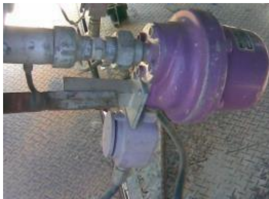
Figure II.2-5 Détecteur de flamme
