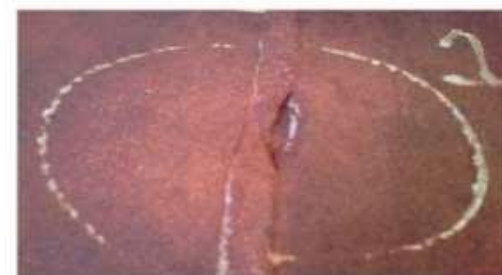
Figure 1-f : Corrosion en cordon de soudure
