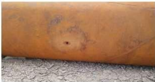
Figure 1-a : Corrosion externe par piqure
