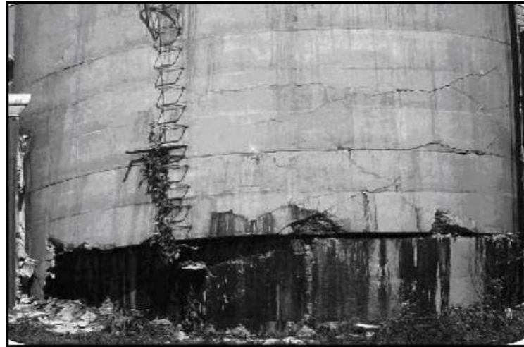
Fig. I.6 : La détérioration des silos-tours en béton due à l'attaque des acides d'ensilage.
