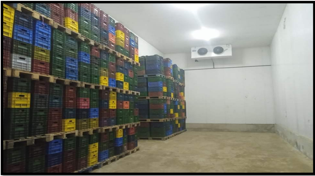
Figure 20 : Stockage de la pomme de terre dans la chambre froide.
