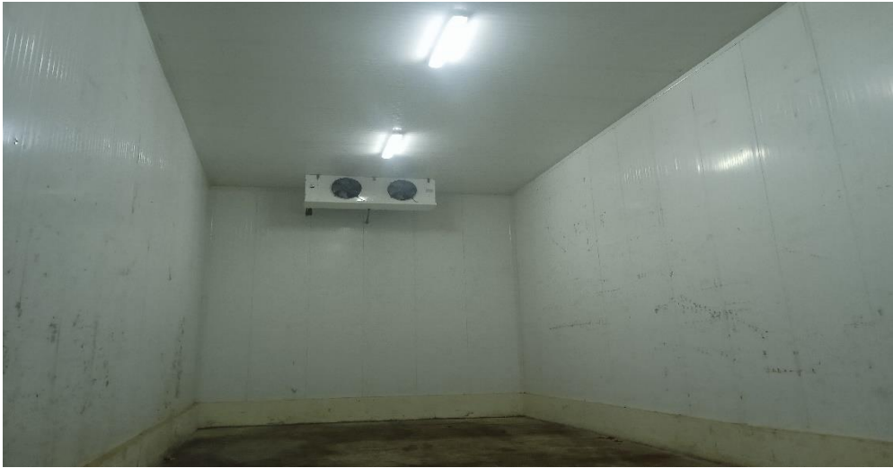
Figure : Chambre froide de pomme de terre.
