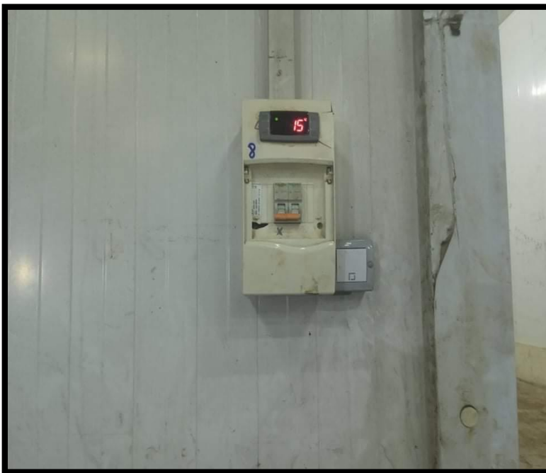
Figure 21 : Thermomètre de la chambre froide.
