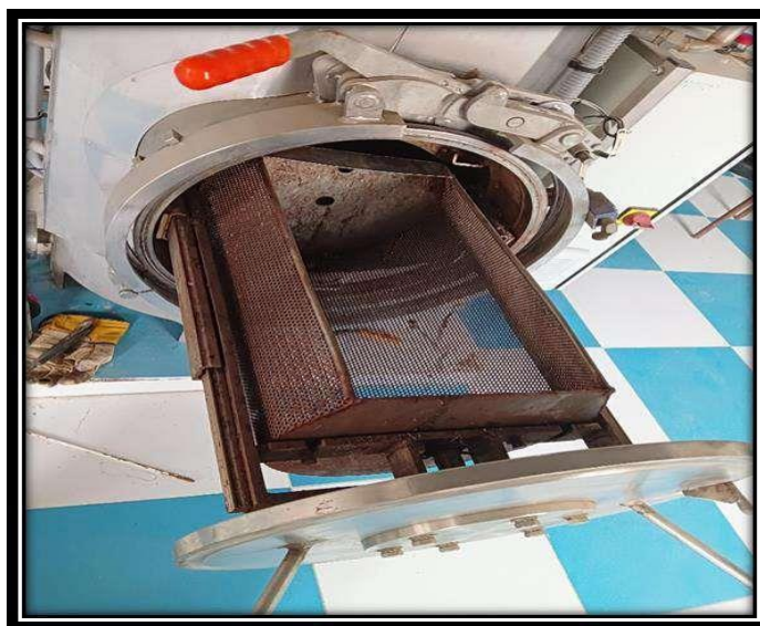
Figure22: Durant l'opération de la banalisation de l'EPH de Collo.
