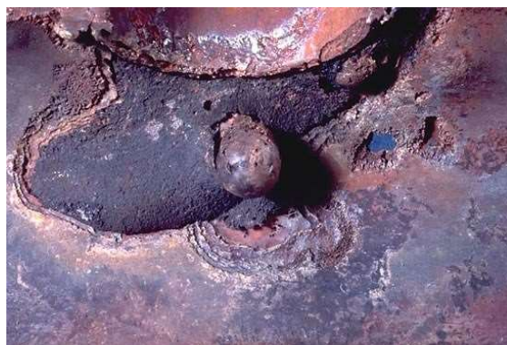
Figure I.6 Corrosion galvanique d'une pièce.
