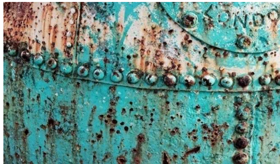
Figure I.5 Corrosion localisée d'un acier.
