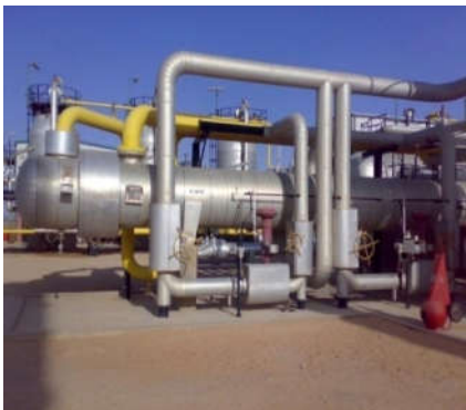
Figure IV.7 : Echangeur gaz-gaz E403A/B
