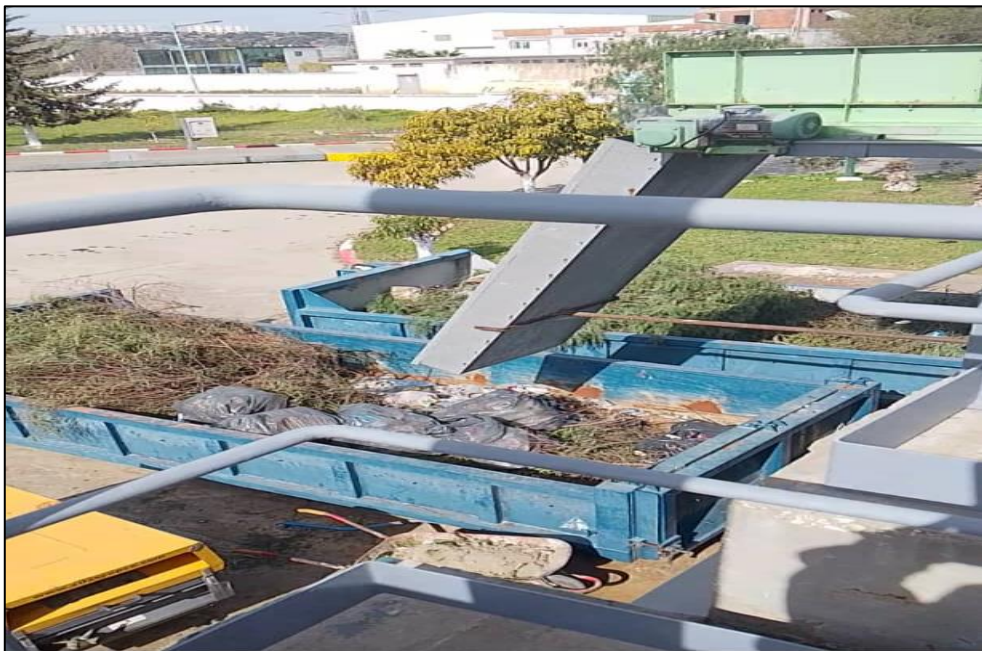
Figure III.9. Dégrillage fin Manuel Et Automatique.
