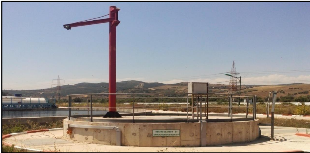
Figure III.15. Poste de recirculation et extraction des boues.
