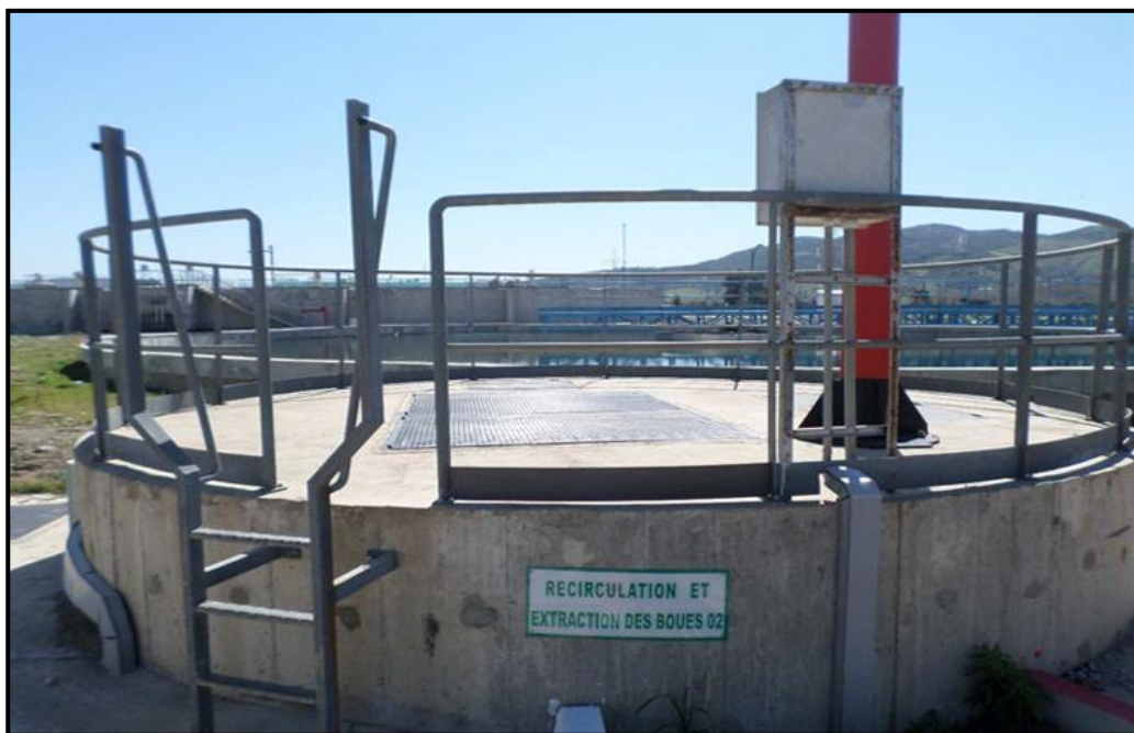
Figure III.18. Structure du traitement des boues.
