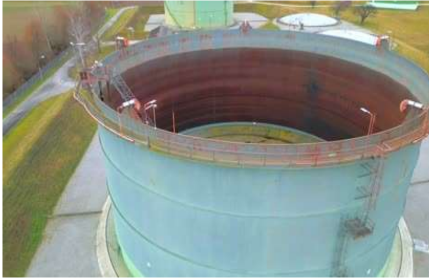
Figure I.5 : Le réservoir à toit flottant externe
