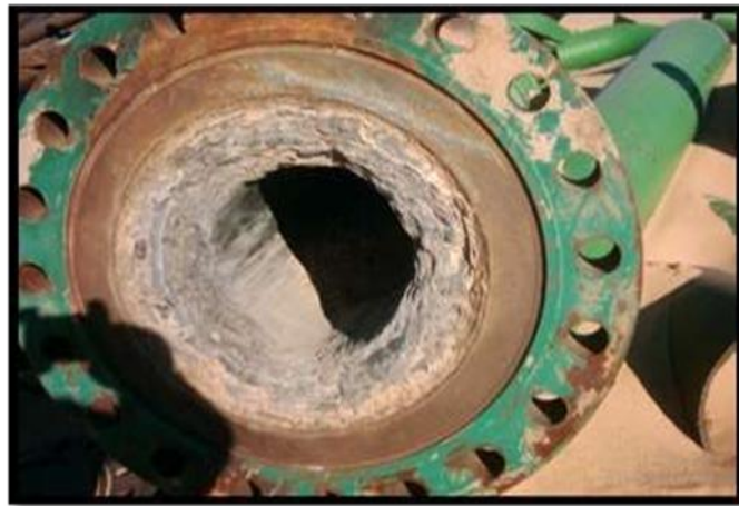
Figure IV.2: Dépôt BaSO 4 au niveau d'une canalisation
