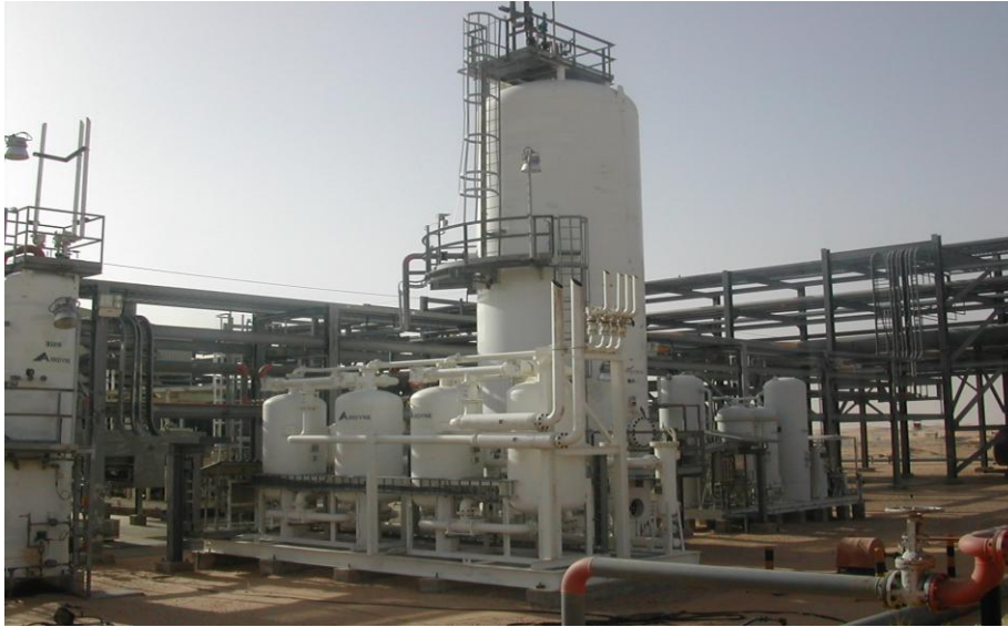
Figure I.1.6: Unité de compression et de traitement de l'air pour l'alimentation en air instrument (CPF/TCF)
