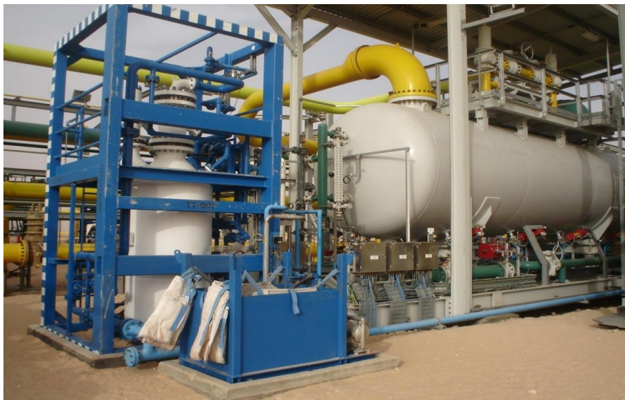
Figure I.3 : Séparateur haute pression 10-V-27000.
