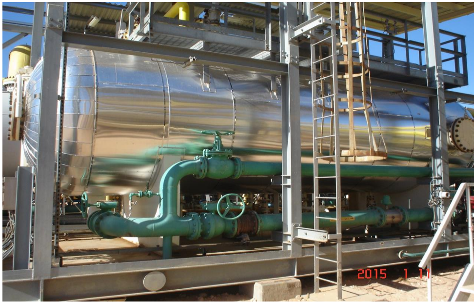
Figure I.6 : Séparateur basse pression 10-V-255
