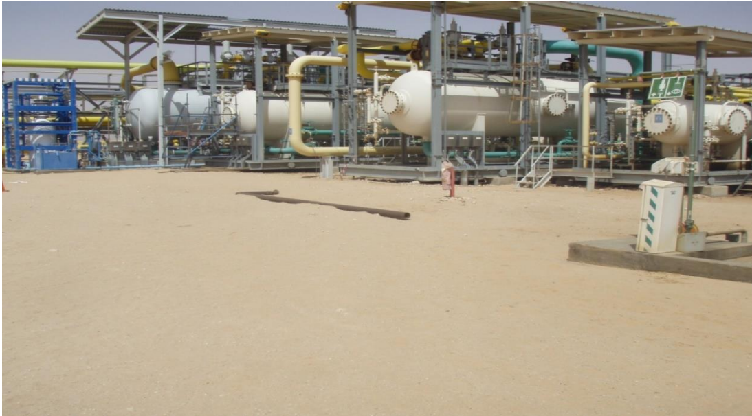
Figure I.2 : Unité de séparation du centre GS1.
