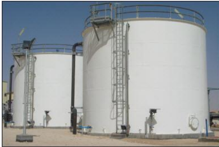
Figure I.17 : Deux bacs de stockage 40-T-230/231.
