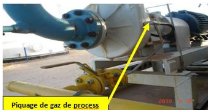
Figure II.8 : Photo montrant le piquage de gaz
