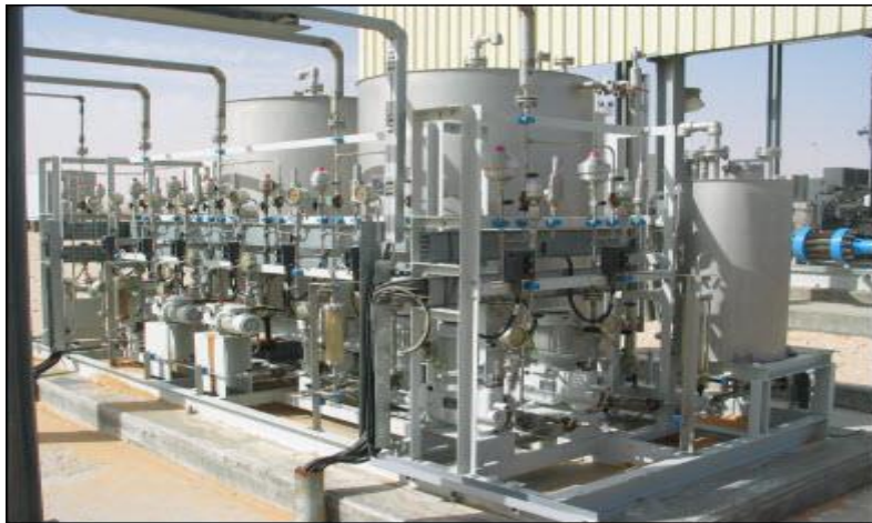
Figure I.20 : Skid d'injection de produit chimique.
