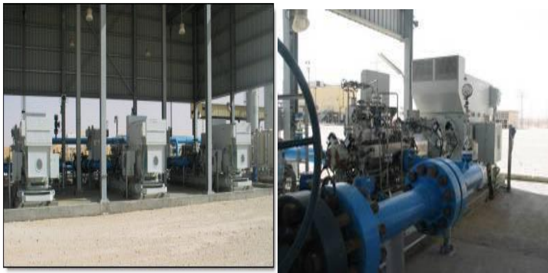
Figure I.21 : Pompes d'injection d'eau produite 40-P-202A/B.
