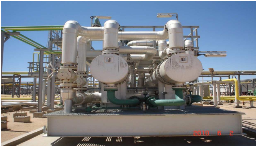
Figure I.10 : Echangeurs de chaleur 12-X-20400A/B.
