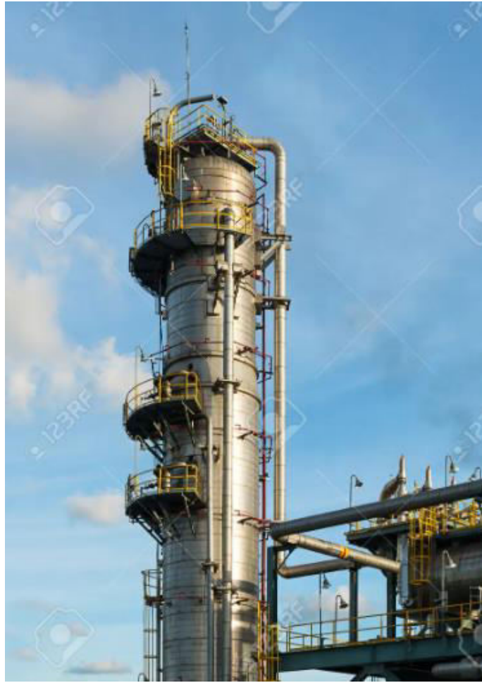
Figure I.8 Colonne de distillation atmosphérique
