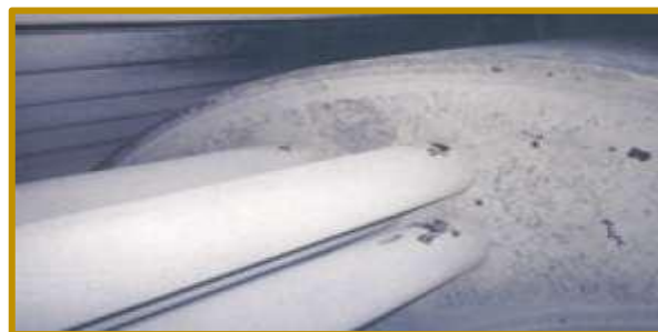
Figure 16 : Entarfrage d'une chaudière à tubes de fumée (P=15 bar).
