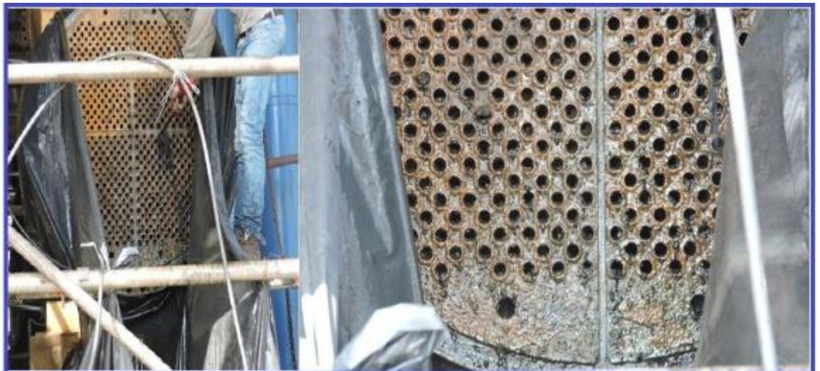
Figure I.8 : corrosion d'échangeur de chaleur E_115 .
