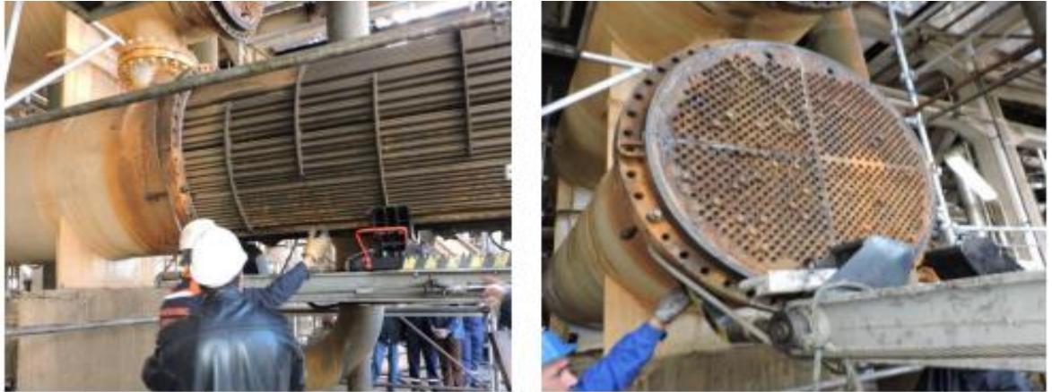
Figure I.9 : L'état de l'échangeur E-115 (Encrassement et Bouchage)
